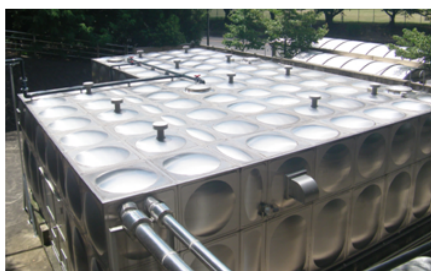
給水設備(受水槽) 受水槽容量126t！
