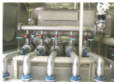
給水設備(給水ポンプ) 台数制御・インバータ制御！
