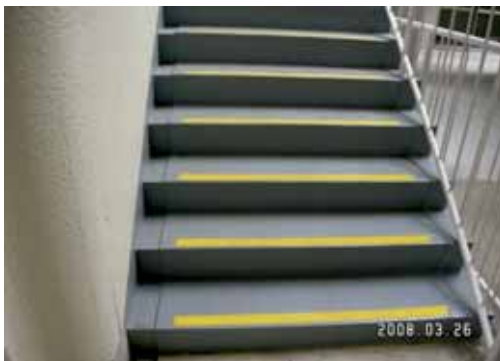
落下防止のため着色された屋外階段
