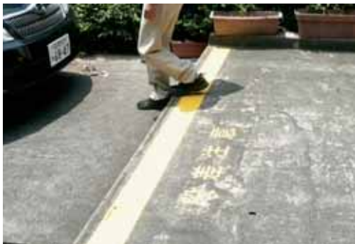
捻挫事故後に表示された通路の段差注意
