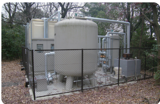
井水プラント（高度浄化設備）
