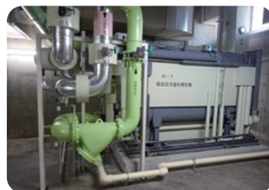
冷温水発生機（講堂）
