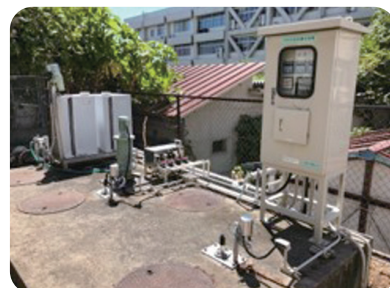
中和処理施設（pH 常時監視）により実験系排水を管理
