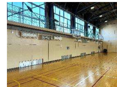
附属高等学校（体育館空調設備）
