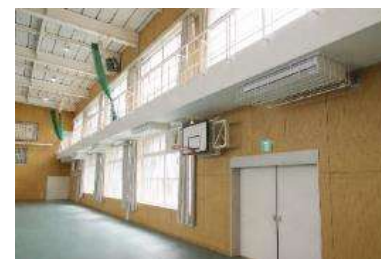
附属岡崎小学校 （体育館空調設備）
