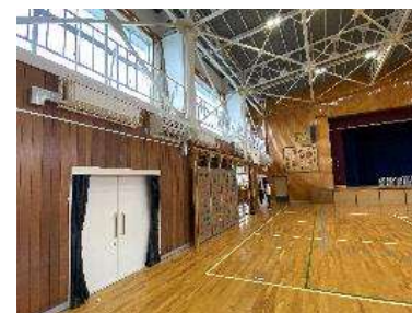
附属名古屋小学校（体育館空調設備）
