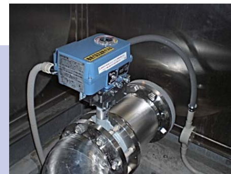
災害時に受水槽の水を有効利用できる
