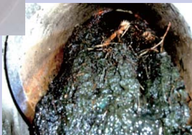
改修前（管内に木の根が進入）
