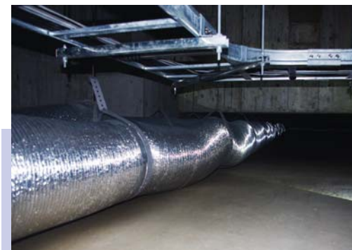
土中・地下ピットに設けたエアダクト導入による熱負荷低減
