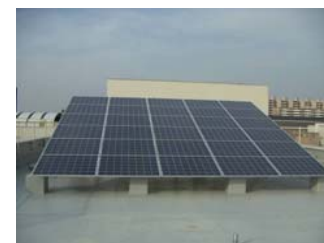
太陽光発電設備
