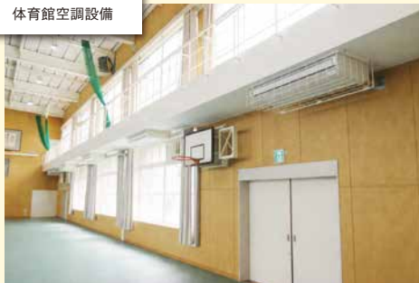
体育館空調設備
