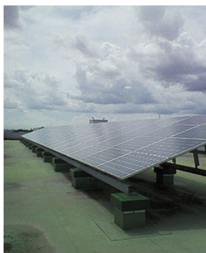
太陽光パネル設置(屋上) 美術・技術・家政棟 演習室棟 図書館 附属小中高, 特別支援学校
