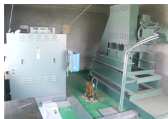
エレベータ機械室
