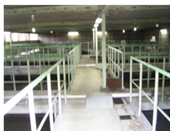
排水処理施設
