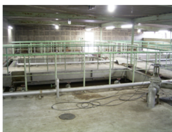
排水処理施設 構内(汚水・雑排水)を処理！
