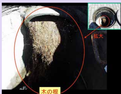
木の根の詰まりによる排水不良の例
