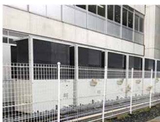
高効率空調機
