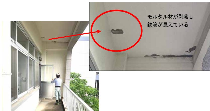
図 2-16 外装仕上げ材の剥落
