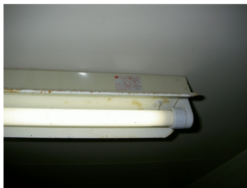
図 2-15 老朽化した照明器具
