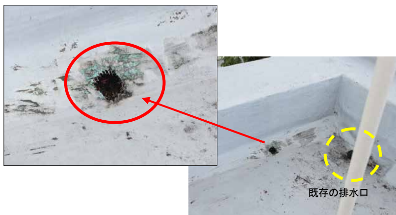
図 2-17 防水層の破れからの雨漏り
