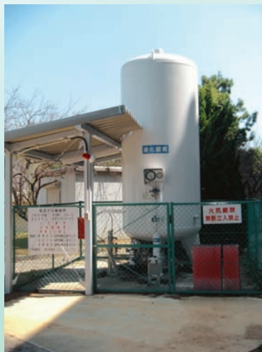
液体窒素貯槽
