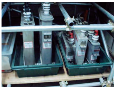
保管状況時の高圧コンデンサ(H21.3)
