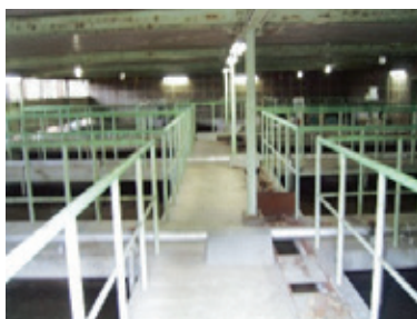
生活排水処理施設 (設置：昭和 50 年度)
