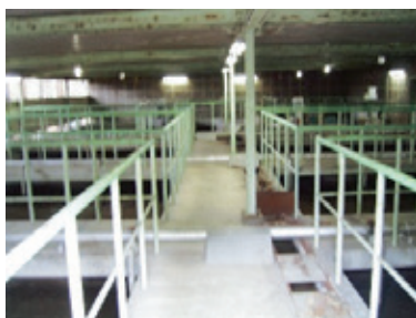
生活排水処理施設 (設置：昭和 50 年度)
