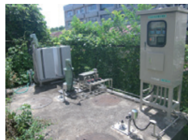
中和処理施設 (改修：平成 23 年度)
