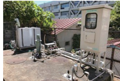
中和処理施設（pH常時監視）により実験系排水を管理
