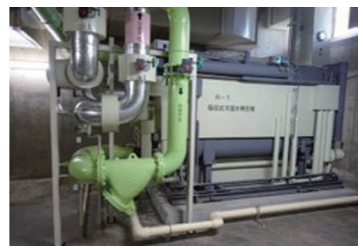
冷温水発生機（講堂）
