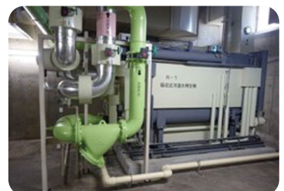
冷温水発生機（講堂）
