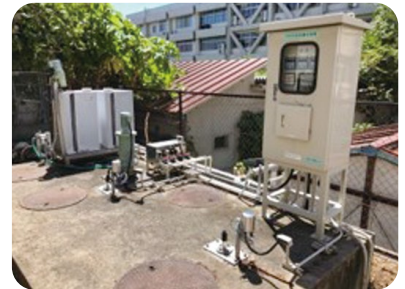
中和処理施設（pH 常時監視）により実験系排水を管理
