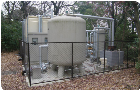
井水プラント（高度浄化設備）
